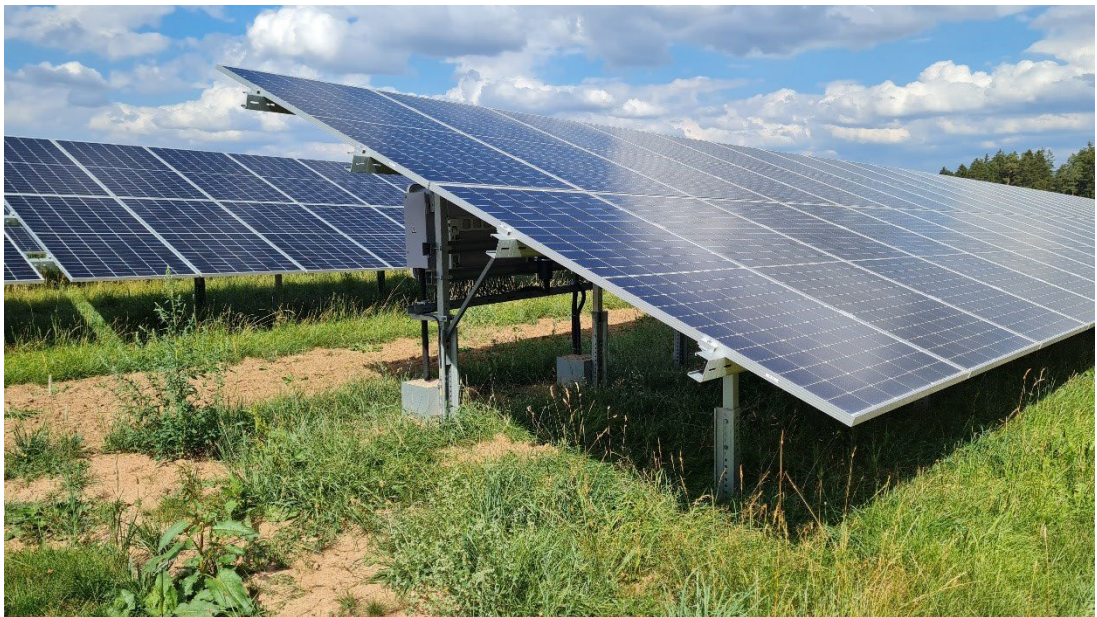
Kuva 9 Esimerkki maavaraisesta aurinkovoimala-asennuksesta. Kuva Fortum.
